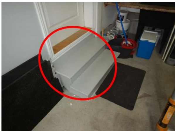
Absence de garde-corps sur le côté de l'escalier
