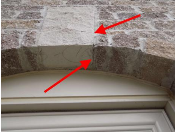
Fissure au joint de mortier du linteau de pierre
