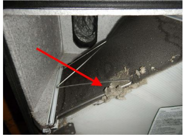
Filtre de l'échangeur d'air à nettoyer
