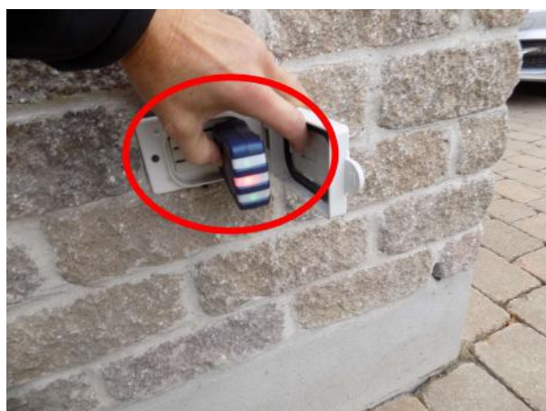
Pprises de courant extérieures avec protection DDFT défectueuse
