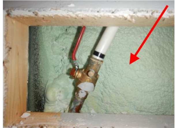
Isolant de polyuréthane visible par l'orifice du mur de la valve principale
