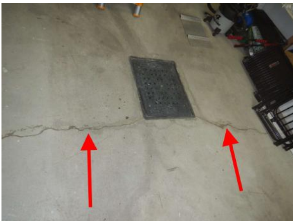
Fissure sur la dalle de béton du garage
