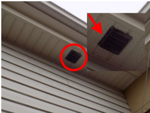
Mauvais registre du ventilateur de salle de bain
