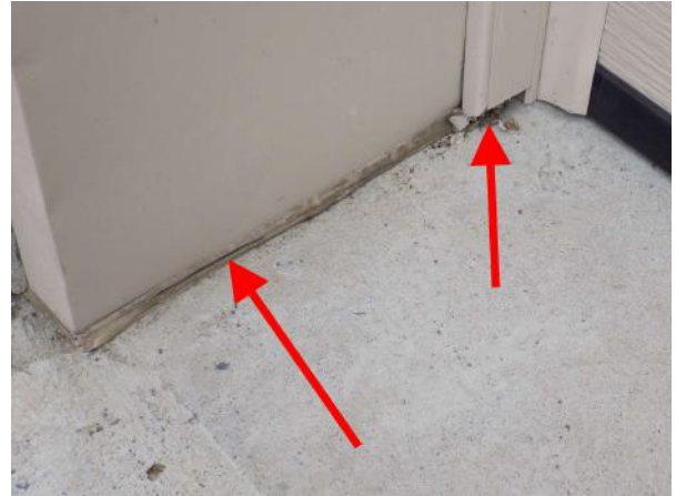
Scellant fissuré dans le bas du cadre de la porte avant
