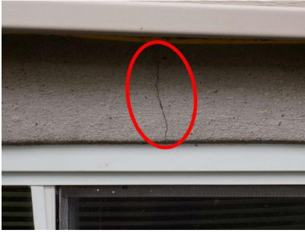
Fissure au-dessus de fenêtre en façade gauche
