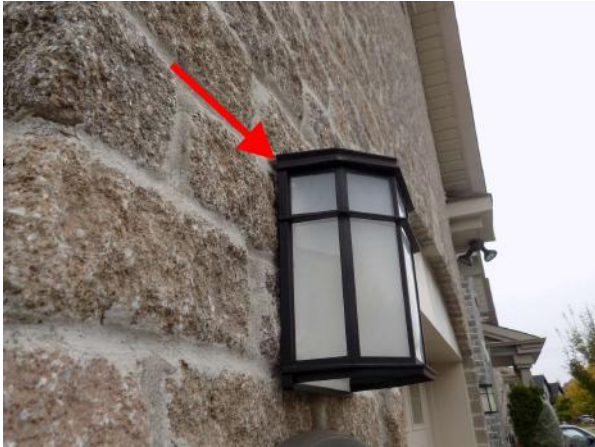
Scellant manquant au pourtour des luminaires avant
