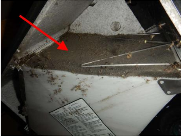
Filtre de l'échangeur d'air à nettoyer
