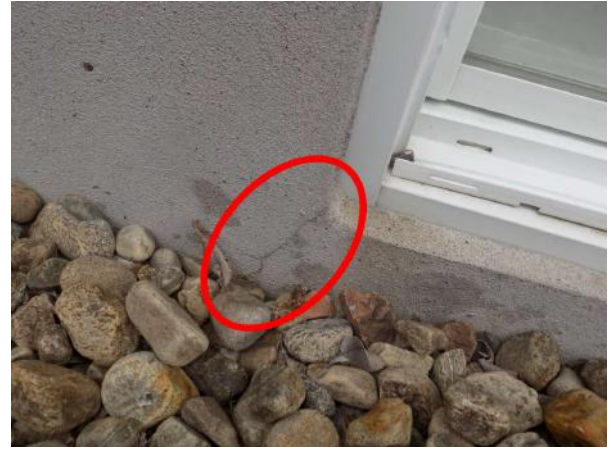
Fissure sous la fenêtre en façade gauche
