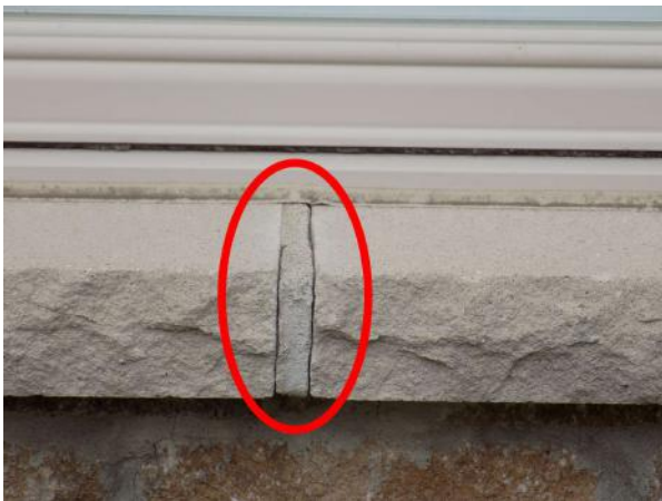
Fissure au joint de l'allège jointoyée de la fenêtre
